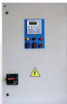
ШУ с устройством плавного пуска для электродвигателей мощностью 80кВт
