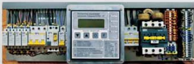
Модуль управления насосом (МУН)
